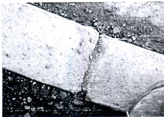
Fotografía N° 15 – 6/03/2015: Solera con emboquillado fisurado en calle Victoria.
