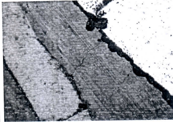
Fotografía N° 20 – 6/03/2015: Fisura en zarpa de hormigón. Calle Francisco Bilbao.
